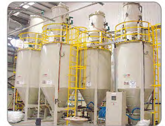
▲ 原料儲存桶 MATERIAL STORAGE TANK
