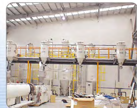
▲ 自動輸送管線至押出機 AUTOMATIC CONVEYING SYSTEM TO EXTRUDER
