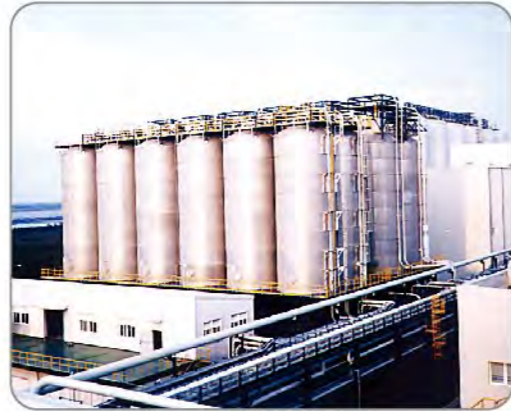
▲ 100噸SILO 100-TON SILOS
