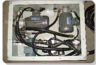
▲ 自動加油設備 AUTO OIL METERING UNIT
