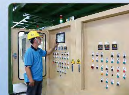
控制系統 CONTROL SYSTEM
