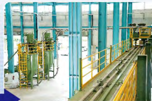
▲ D. 管鍊輸送系統至押出機 CHAIN CONVEYOR SYSTEM TO EXTRUDERS
