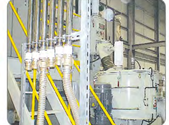
▲ 自動輸送管線 AUTOMATIC PIPE CONVEYING SYSTEM
