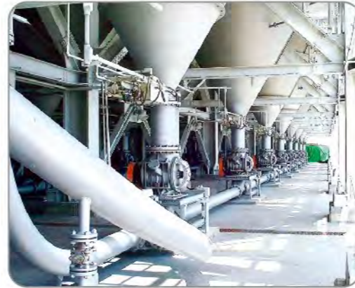
▲ 自動輸送系統 AUTOMATIC CONVEYING SYSTEM
